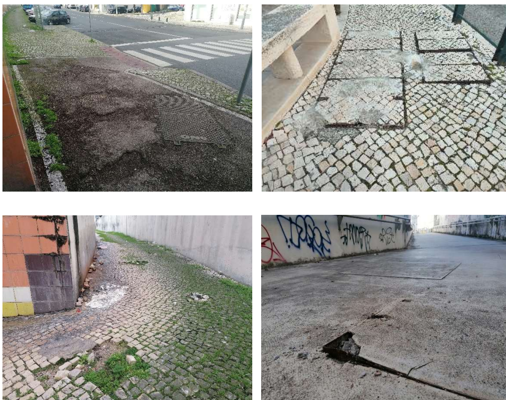
Figura 6.6 – Exemplos de pavimentos em más condições
